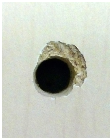
Рис. 2. Дефект обработки сверлением
