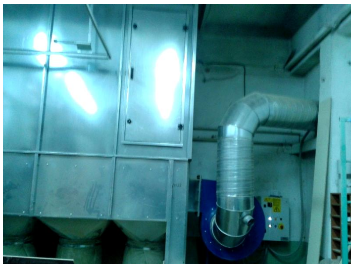
Рис. 6. Аспирационная установка с рукавными фильтрами (Coima, Италия) для удаления отходов от HOLZMA HPP 350/32/32, вынесенная в отдельное помещение
