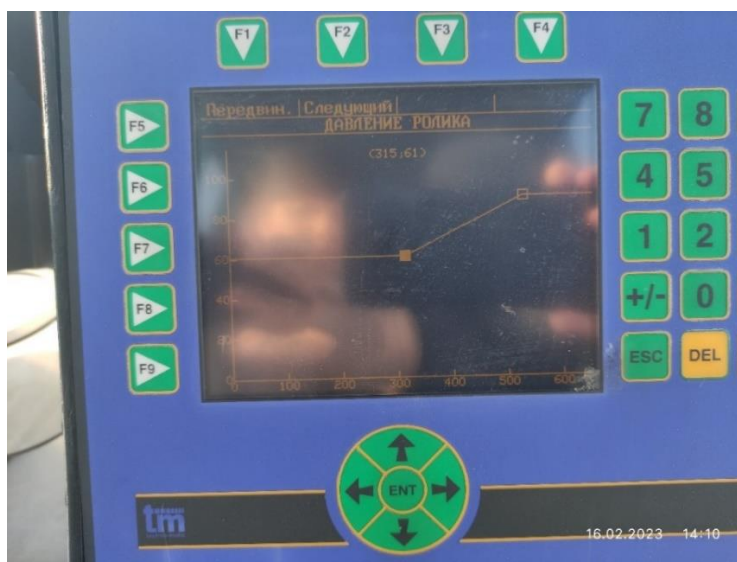
Рис. 1. Копия экрана заводских настроек давления по линейному закону протаскивающих валцов на измерительной системе Tech Measure 1000
