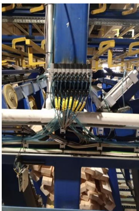
Рис. 3. Система распределителей пневмопривода на площадке обслуживания
